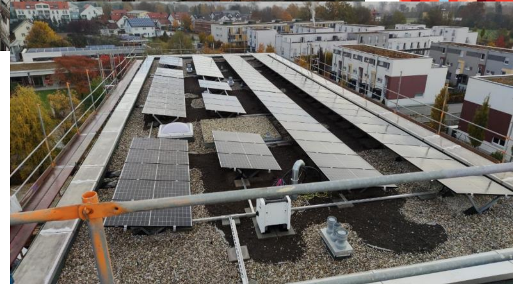
PV-Anlage der BEG auf dem Dach in der Kath.-Maier-Str.
